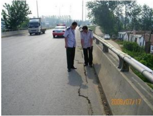
挡土墙墙身外倾,墙顶部分明显外移
